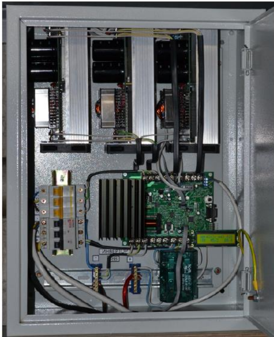
Рис. 5.15 – Зовнішній вигляд керуючого контролера ВЕУ.
